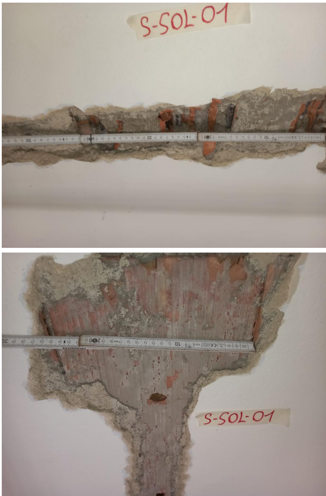
Foto 17. Rappresentativa Ispezione diretta su solaio denominata “S_SOL_01”
