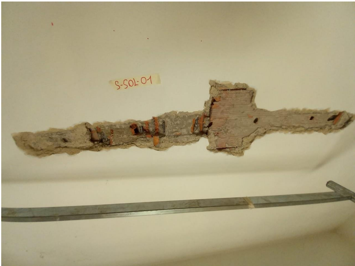
Foto 19. Rappresentativa Ispezione diretta su solaio denominata “S_SOL_01”
