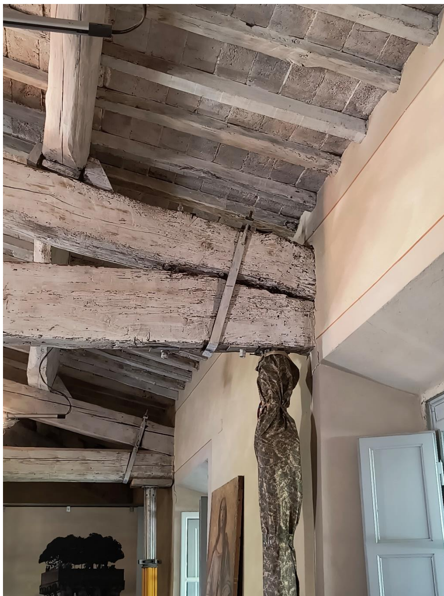
Puntellamento dell'appoggio di due capriate e fessurazione localizzata della muratura
