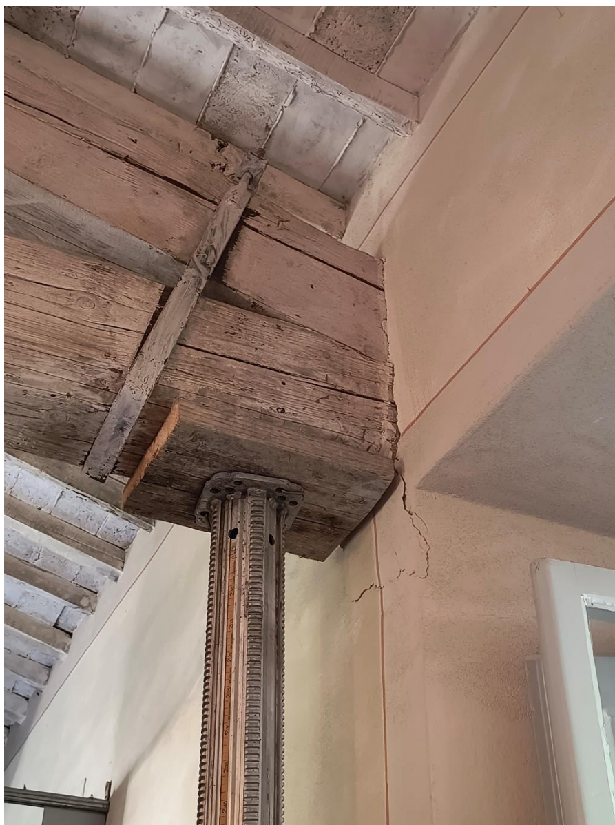
Puntellamento dell'appoggio di una capriata e fessurazione localizzata della muratura
