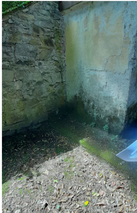
Figura 3 – Vista punto di installazione PDC
