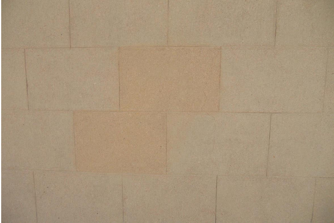
La foto mostra una specchiatura del lato Nord dove si osserva la differente colorazione dei conci, imputabile alla differente pigmentazione dell'intonachino di finitura
